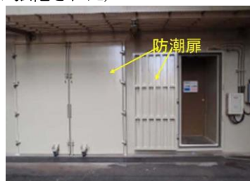
建屋への防潮扉の設置 (津波が侵入しても安全機器を守る。)
