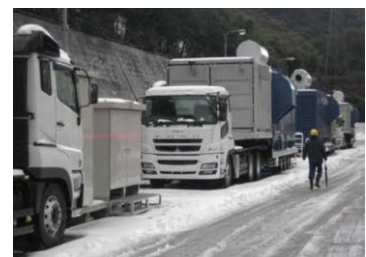
高台への可搬式電源車配備 (地震や津波の影響を受けない予備の電源で、冷やして閉じ込める。)
